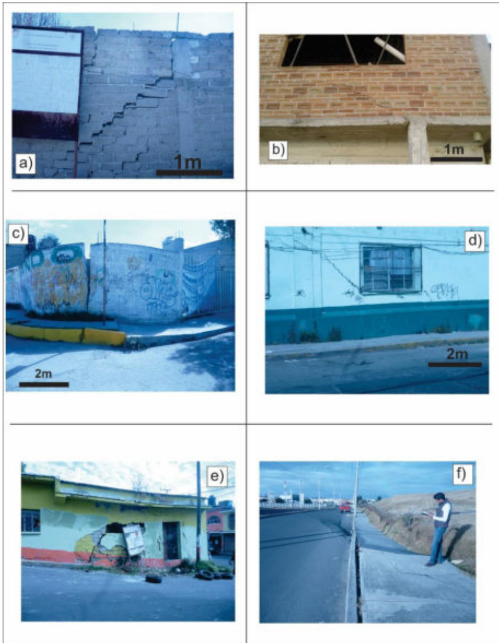
Figura 30 Distintos tipos de afectaciones a la infraestructura urbana en la ZMVT. a) Fallas inversas de acomodo y grietas asociadas en la falla Totoltepec. b) Casa habitación ubicada en la calle 5 de mayo, col. San Pedro Totoltepec, afectada por grietas y se abandonó la idea de continuar su construcción en el segundo piso. c) Fallas y grietas de la falla Totoltepec que pasa por la avenida en Santa María Totoltepec. d) Afectación a una escuela primaria en la calle 16 de septiembre de la col. Santa Ana Tlapaltitlan. e) Casa habitación totalmente destruida por falla geológica en la calle Benito Juárez de la col. San Mateo Oxtotitlán. f) Falla normal con desplazamiento de 50cm, afectando la avenida Ocotitlán, de la colonia la Magdalena Ocotitlán.
