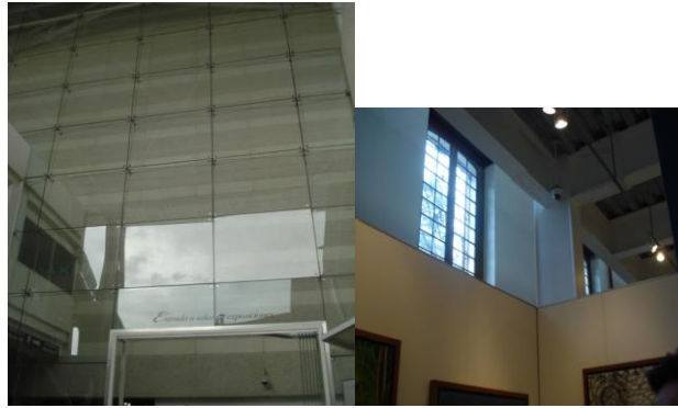
Imagen 86 Paradoja: Duplicación de muros al presentar un muro-cortina de cristal paralelo a muro de concreto (izquierda) y muro interior de durock en zona de exposiciones paralelo al muro original (derecha). (Solano, 2012)
