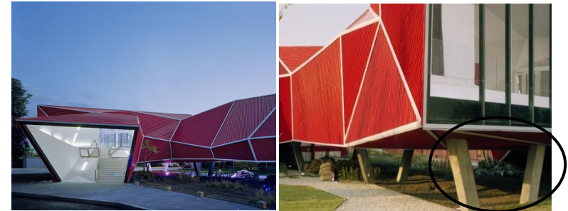
Imagen 70 Paradoja y Desconcierto: La elevación injustificada de la estructura sobre el nivel del terreno y la presencia de pilotes oblicuos sustentando la estructura. ( http://arquitecturainteligente.wordpress.com , 2007)
