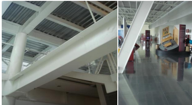
Imagen 94 Obscenidad: Materiales y estructuras aparentes. Estructuras, losa, columnas y muros (izquierda) y pisos (derecha). (Solano, 2012)
