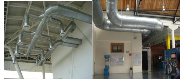
Imagen 95 Obscenidad: Instalaciones evidentes y exageradas, ductos fuera de proporción. (Solano, 2012)
